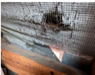
Zdegradovaná parotěsná doplňková hydroizolační vrstva
