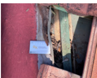
Odvodňovací klempířský prvek je ucpaný těsnícím klínem (pěnou)
