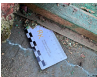
Spoje doplňkové hydroizolační vrstvy nejsou slepené
