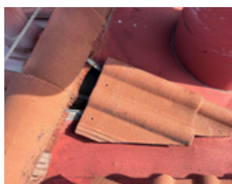
U hřebene chybí mechanické kotvení skládané betonové krytiny
