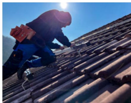
Realizace FVE bez podpory spolehlivého partnera je dřina
