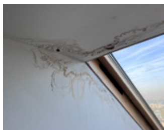
Vlhkostní porucha v místě ostění střešního okna
