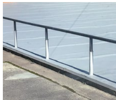
Zábradlí opracované originálními manžetami
