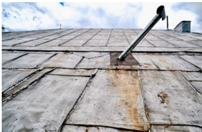
Typická plechová střecha v horském městě Mestia (cca 1 500 m n. m.), jejíž komínek podlehl zubu času a klimatickým vlivům
