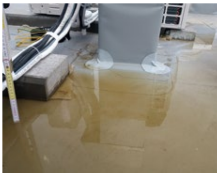
5) Stojící voda na hydroizolaci je začátkem potíží.
