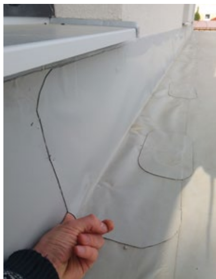
3) Špatně svařená hydroizolační fólie.
