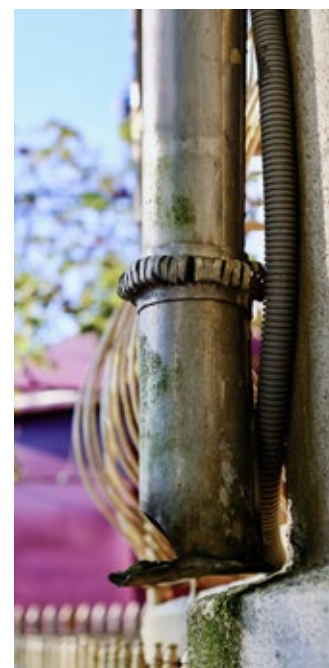
Nebezpečné ostré ukončení svodu umístěné navíc ve výšce očí
