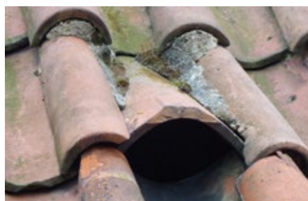
4) Větrací taška ve staré prejzové krytině
