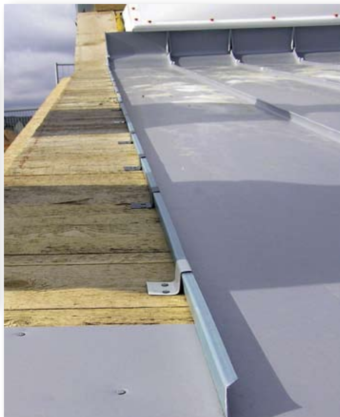
Obr. č. 1 Použití pouze pevných příponek, přichycení podkladního pásu rovněž nedostatečné.
